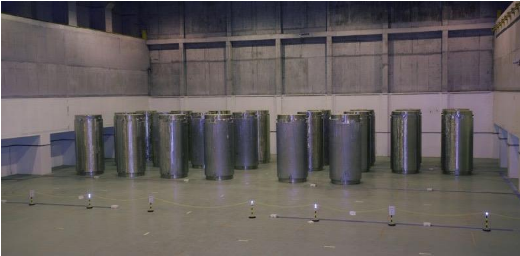
Figura 3-7: ATI de la CN de Trillo
