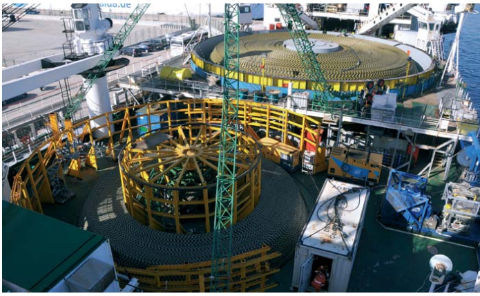
Vista aérea del cable en la cubierta del Giulio Verne .
