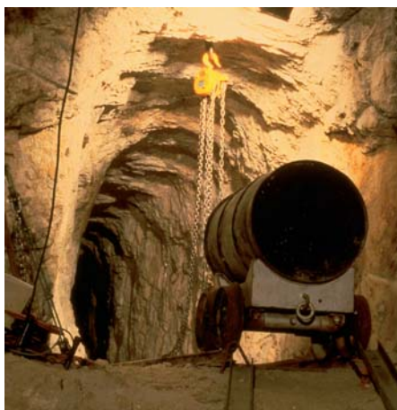
Interior de la Mina Beta, donde se almacenaban inicialmente los residuos radiactivos de El Cabril.
